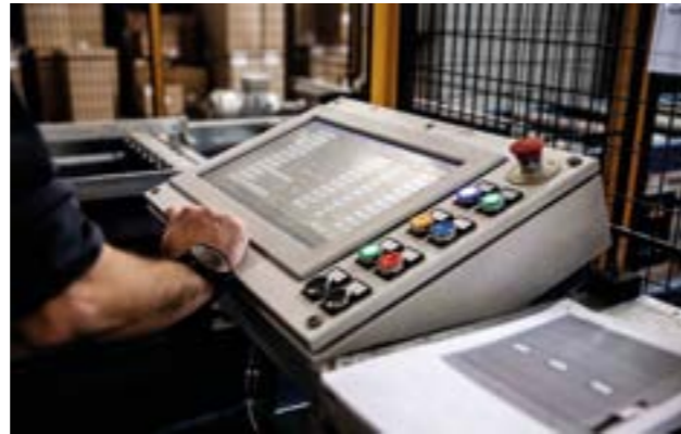
Sistema di controllo automatizzato. Automated control system.
